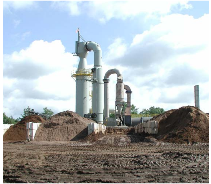
Thermal Desorption Unit
